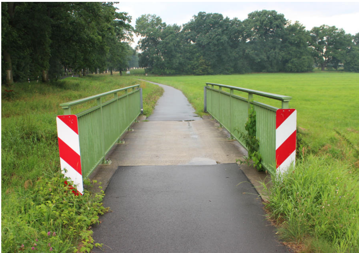
Abbildung 3.105 Brandenburg: RVA Beeskow – Krügersdorf entlang der B246: Vorbildliche Absicherung der Geländerstöße des grün „getarnten“ Brückengeländers. Bild: Dirk Schmidt 2015.
